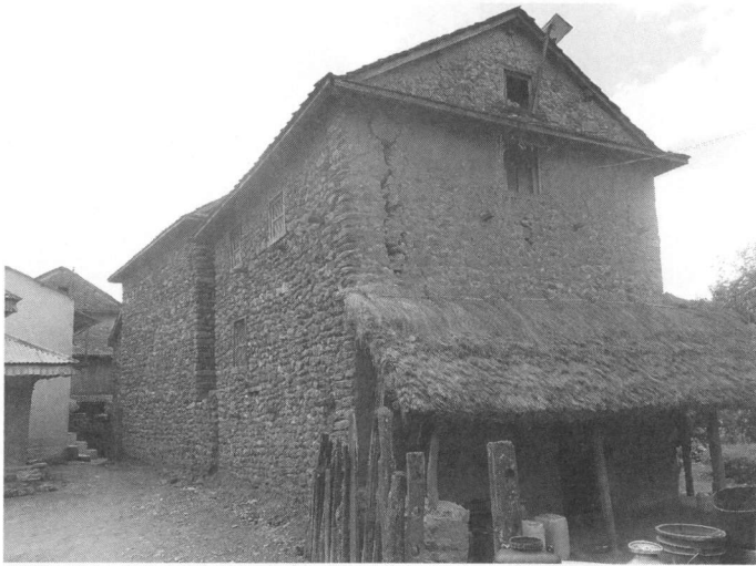
写真2 石を積んで作った家。壁（写真の真ん中上部）に大きな亀裂が見える。
